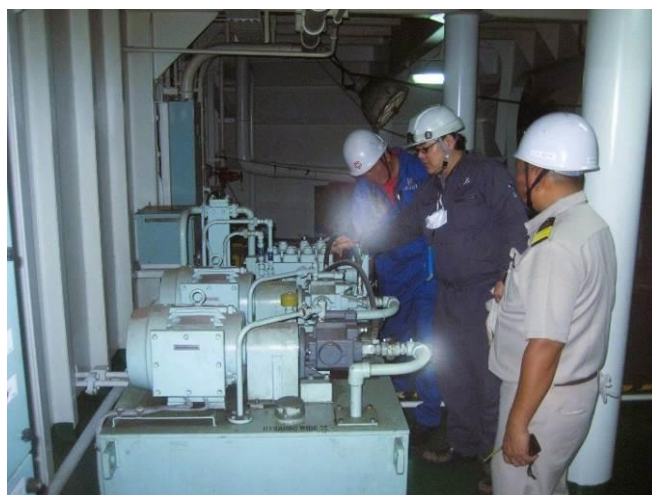
写真 2 研修中の様子（油圧源）①
